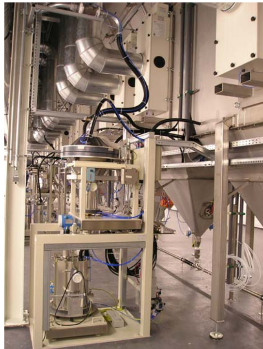
Pulveraufbereitungsanlage EcoPMC Pro im Produktions-einsatz
