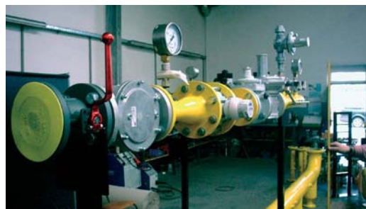
Periodische Erneuerung von Gasregelstrecken zur Erhöhung der Sicherheit
