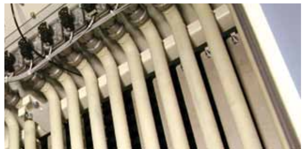
Geöffnetes Filtermodul mit Rückspüleinrichtung
