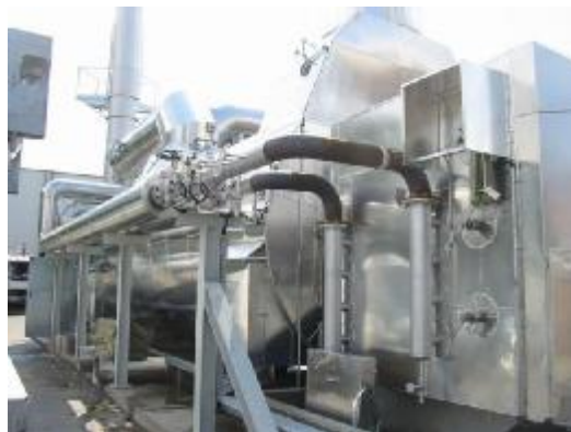
Thermalöl-Anlage bei der Tapetenfabrik Gebr. Rasch in Bramsche.
